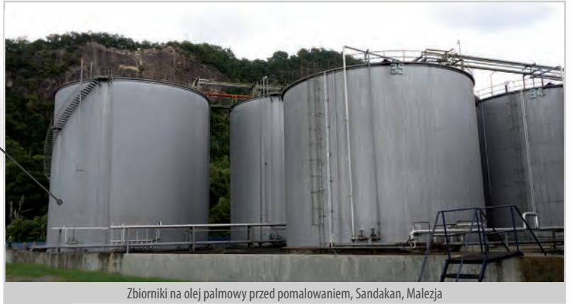
Zbiorniki na olej palmowy przed pomalowaniem, Sandakan, Maleszja
