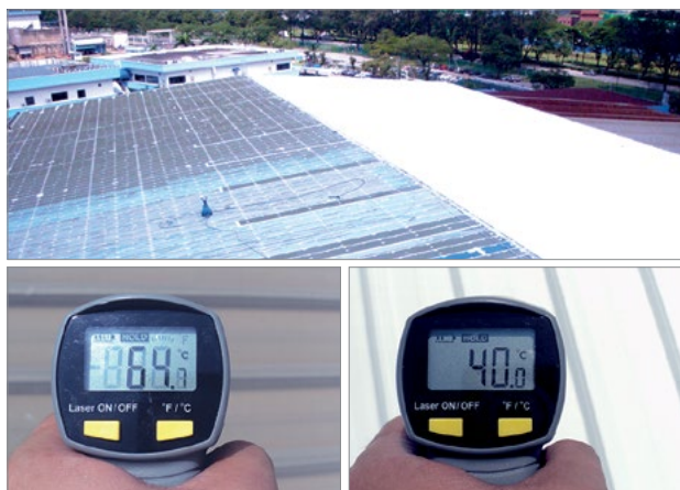
Industriehal in Maleisië. Haldak buiten (vóór - na): De dakcoating zorgde voor een temperatuurverlaging van 24,7°C.
