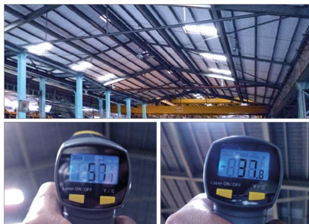
Binnendak (vóór - na): de temperatuur werd met 19,3°C verlaagd. Voordeel: verbeterde arbeidsomstandigheden, energiebesparing, kostenbesparing op het dakonderhoud.
